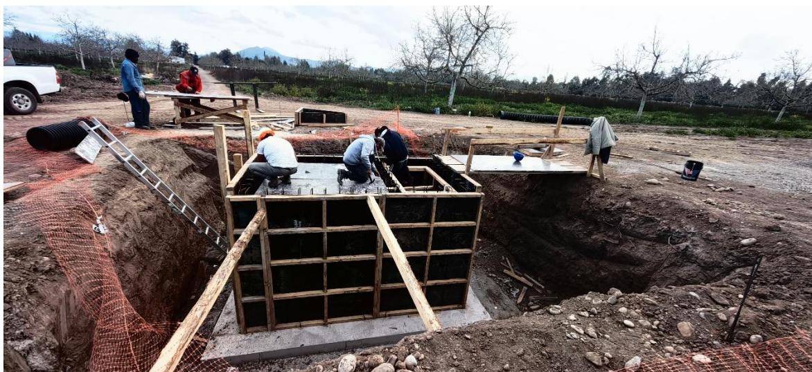
Confección de moldajes para hormigonado de sala de máquinas del sistema de riego.
