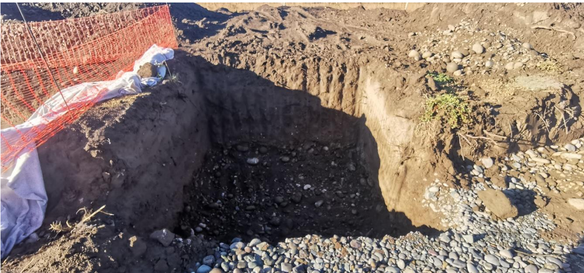
Excavación para emplazamiento y construcción de Cámaras sumidero y cámaras de decantación.
