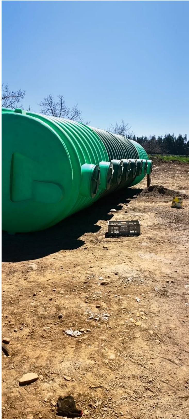
Estanques de acumulación para el agua de riego.
