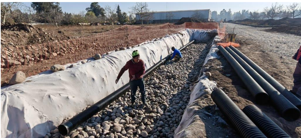
instalación de ductos HDPE 200 mm para drenaje y atravesos de agua potable y riego.
