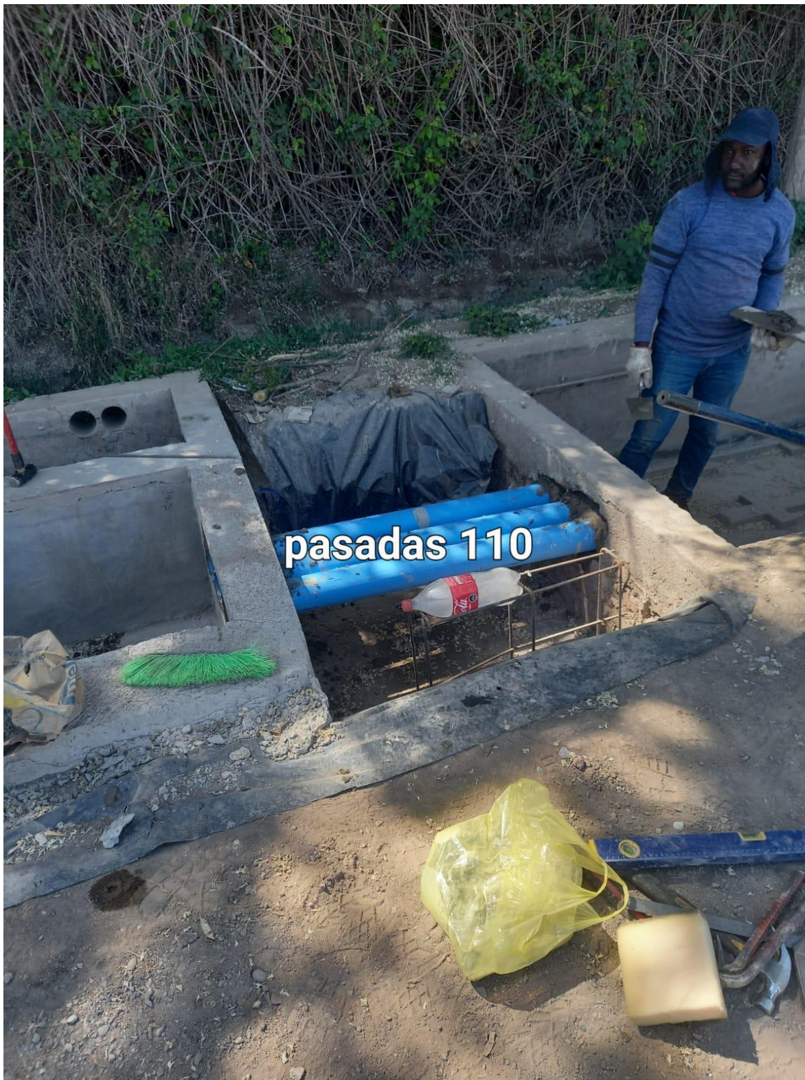
Pasadas entre canal de decantación y piscina decantadora
