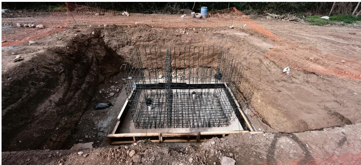
Excavación, emplantillado y efieraduras para sala de máquinas del sistema de riego.
